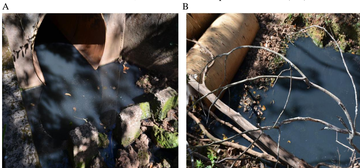
Foto 20 – (A) e (B) Efluente da fábrica de ração da BRF sendo lançado sem tratamento no Ribeirão das Abóboras, localizado no município de Rio Verde (GO).
